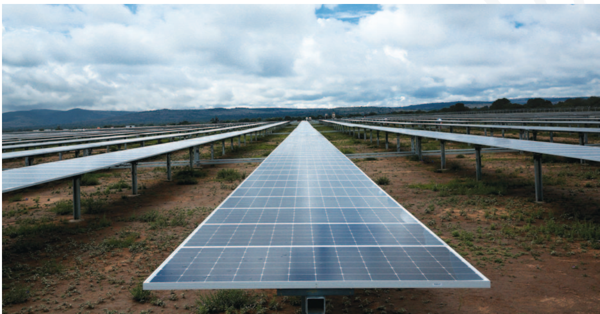
170 MW, Santiago, Mexico.
